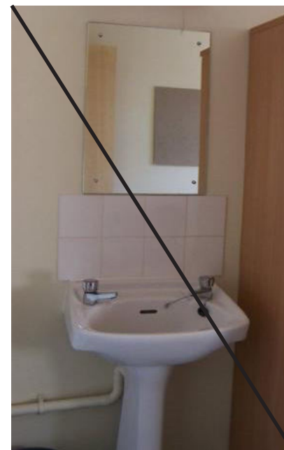
Плохо Раковина с пьедесталом. Фартук из плитки
